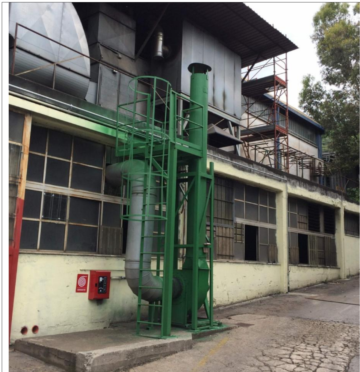
Figura 2.12 – Fonderie Pisano: stralcio fotografico della sorgente emissiva E11 – camino (Data: maggio 2016).
