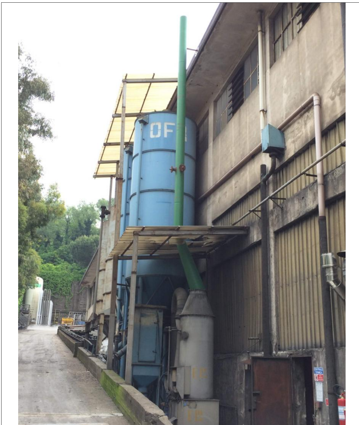
Figura 2.13 – Fonderie Pisano: stralcio fotografico della sorgente emissiva E12 – camino (Data: maggio 2016).
