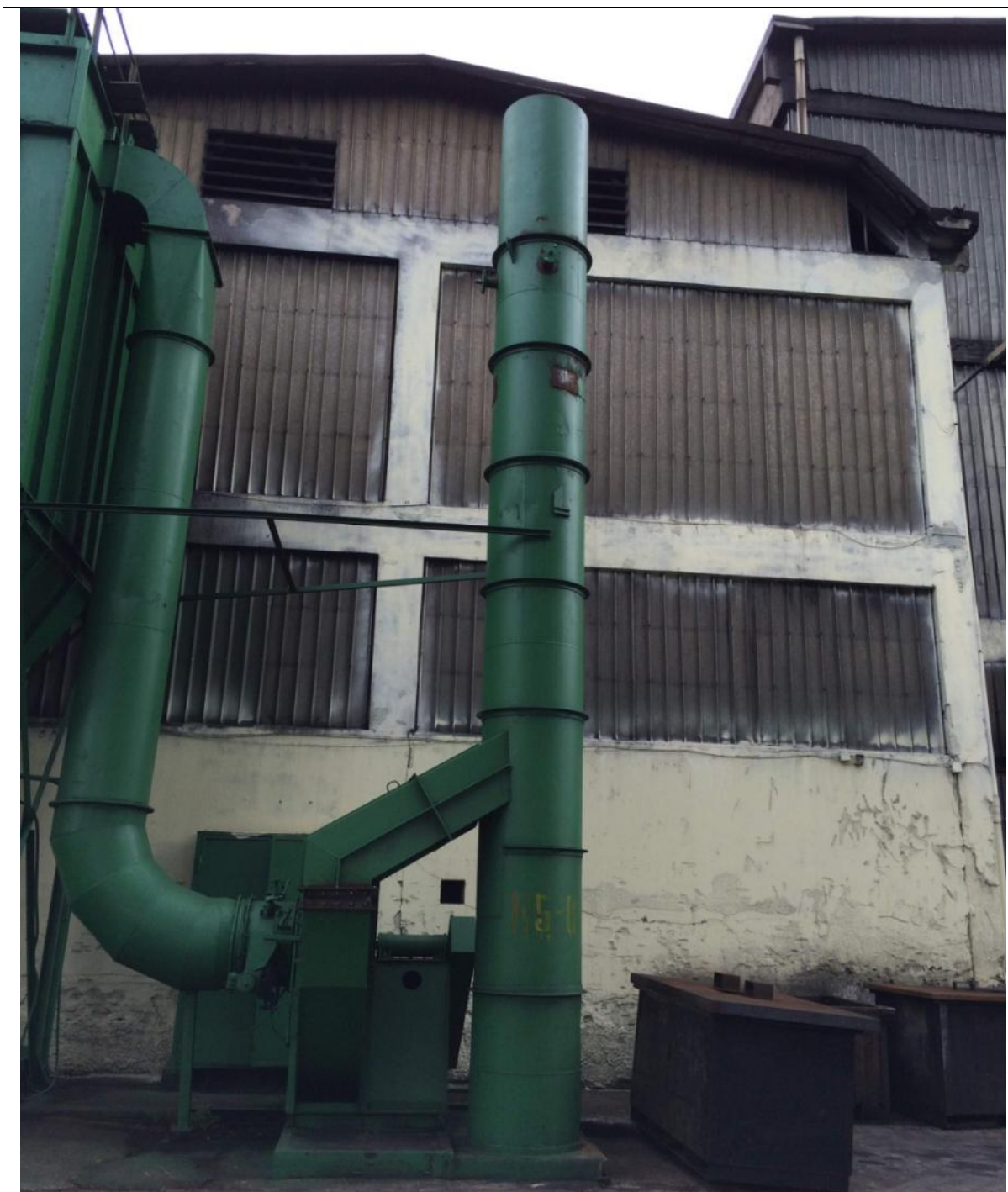
Figura 2.7 – Fonderie Pisano: stralcio fotografico della sorgente emissiva E5-6 – camino (Data: maggio 2016).
